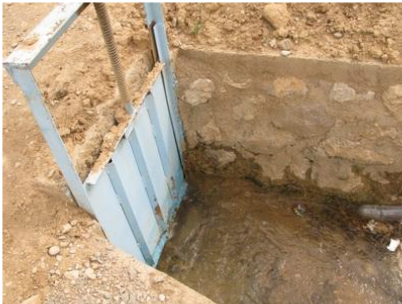
شکل ۱۲- نشت آب از زیر یک دریچه بسته
